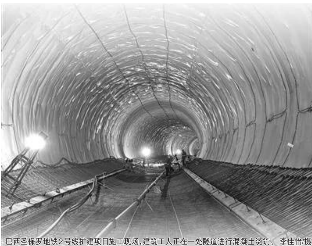
巴西圣保罗地铁2号线扩建项目施工现场，建筑工人正在一处隧道进行混凝土浇筑。李佳怡/摄
