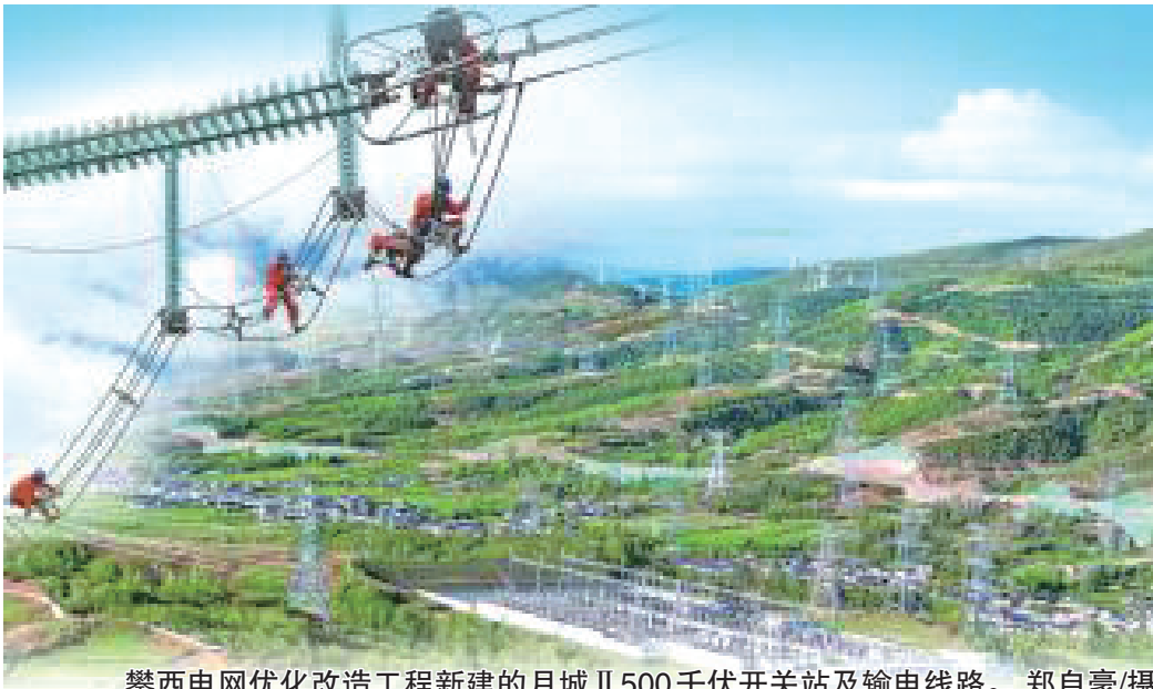
攀西电网优化改造工程新建的月城Ⅱ500千伏开关站及输电线路。 郑自豪/摄
